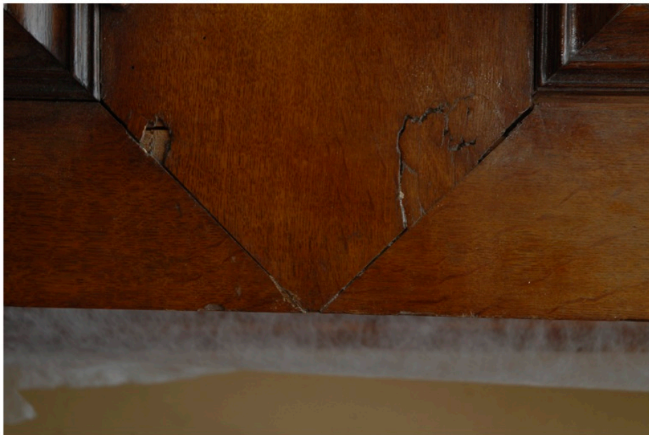
Typowe, powtarzające się uszkodzenia okleiny wynikające z zozeschnięcia się ramowej konstrukcji.
