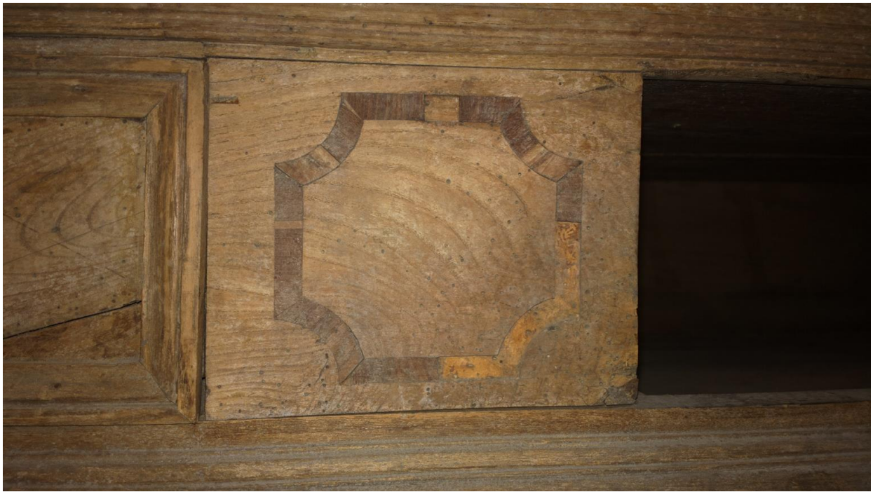
Intarsja odspojona z ubytkami.
