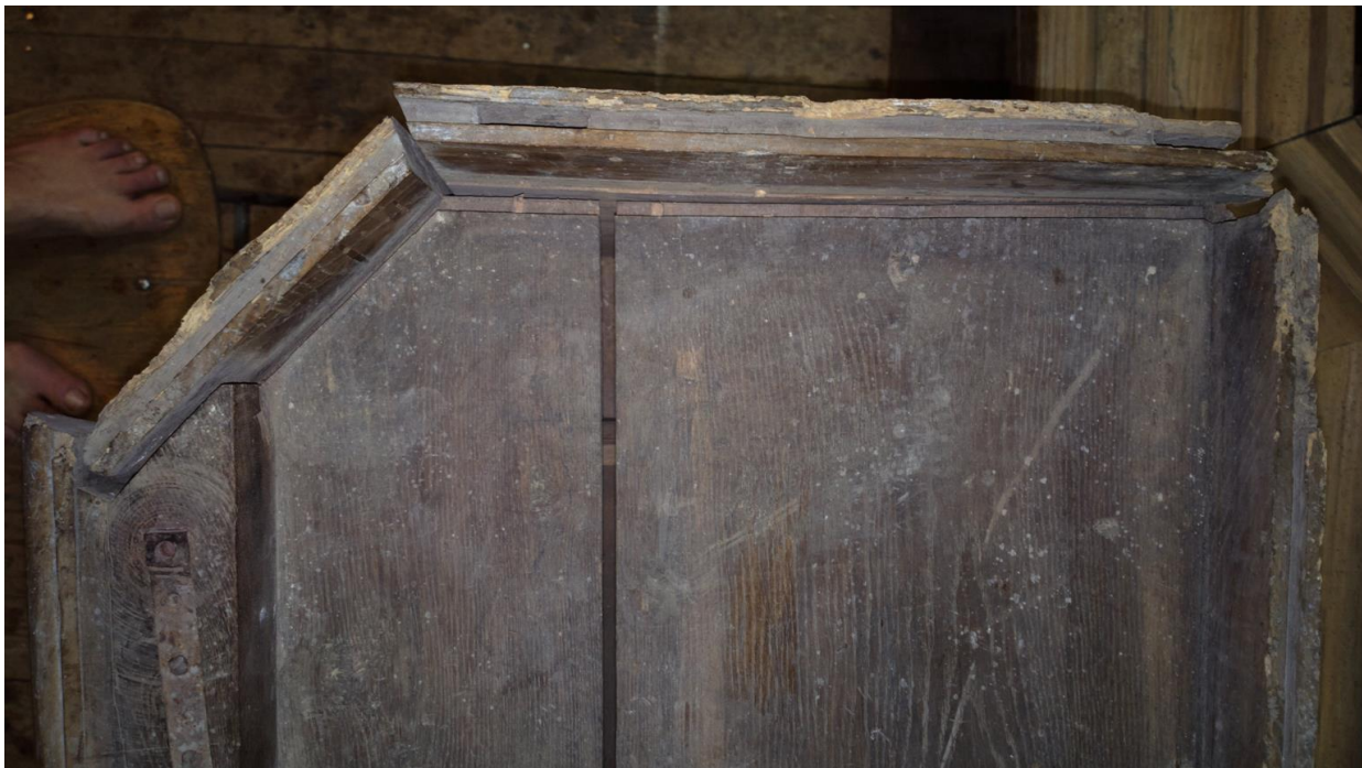
Konstrukcja wieńca dolnego rozklejona , z licznymi śladami po gwoździach i mocno zniszczona przez owady. Naroża wykruszone .
